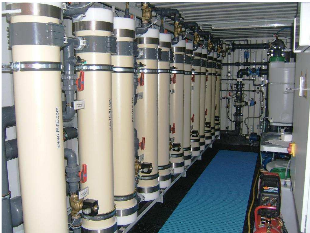
Anlagenbeispiel druckbetriebener LEGIO.module® mit horizontaler Ausrichtung
